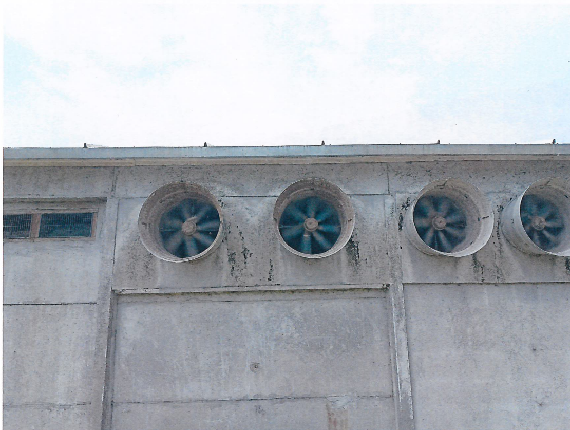
Fot. 7 Działka nr 71/7 obręb Czechy – wschodnia część zakładu – widoczne muchy w okolicy wentylatorów
