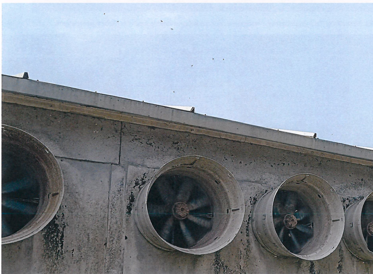
Fot. 6.1 Działka nr 71/7 obręb Czechy – wschodnia część zakładu – widoczne muchy w okolicy wentylatorów
