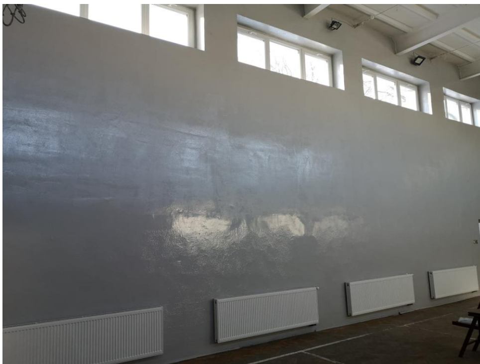
Obrazek 15. Instalacja grzewcza wewnątrz budynku sali sportowej w Krosinie
